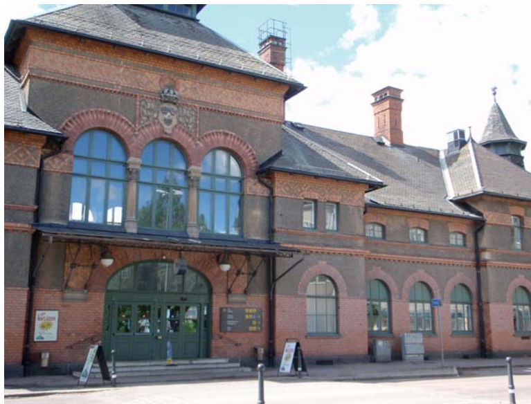
Järnvägsstationens fasader består av rött tegel samt grå putsytor. Putsen var från början ljusgrå men den har mörknat och missfärgats med åren.
