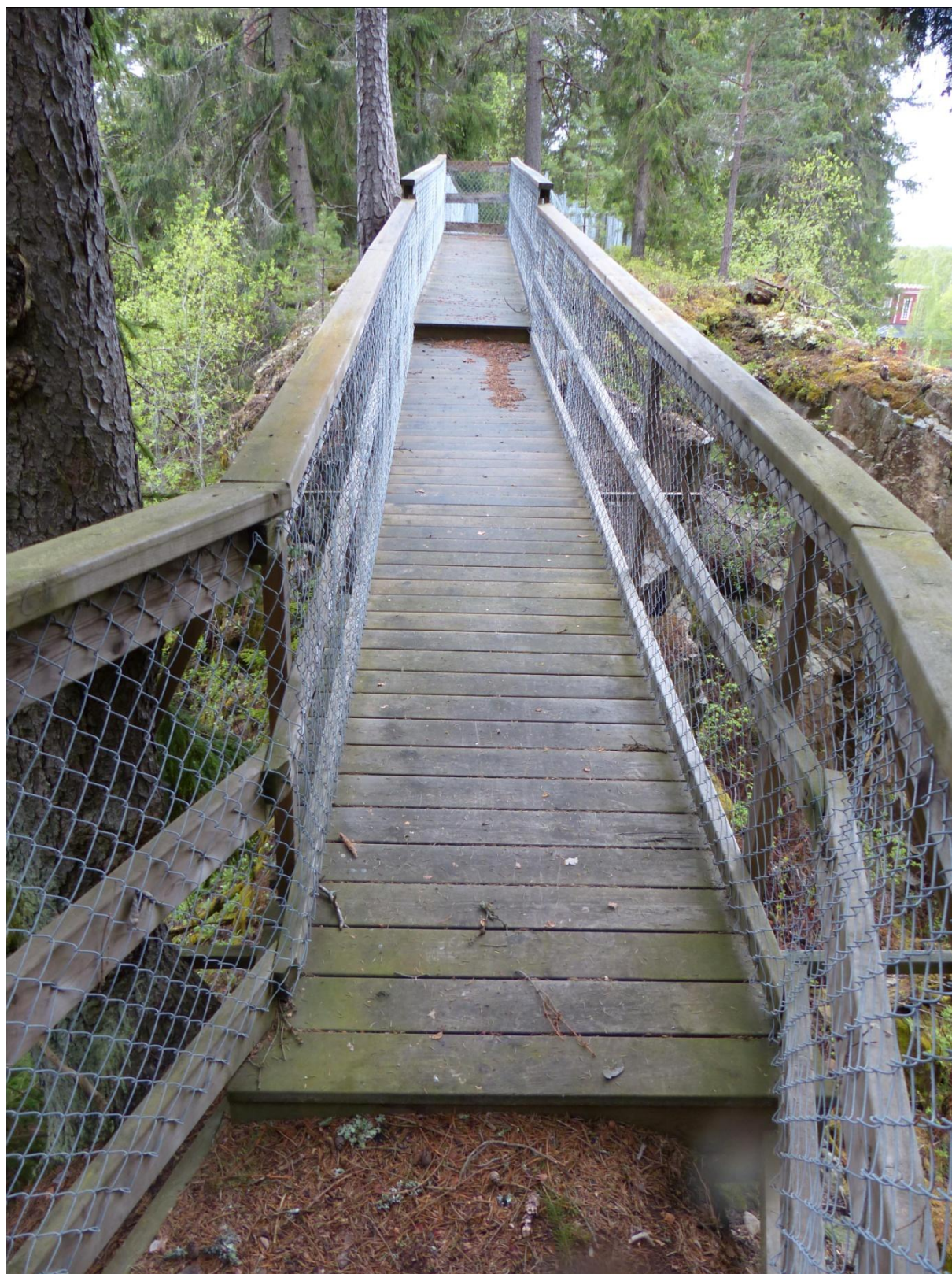
Figur. 16. Bron sedd från östra landfästet. Observera "snubbelhål" i nedre hörnet där träkonstruktionen går i kontakt med de lösa jordlagren på östra anfarten (detalj i figur 17).
