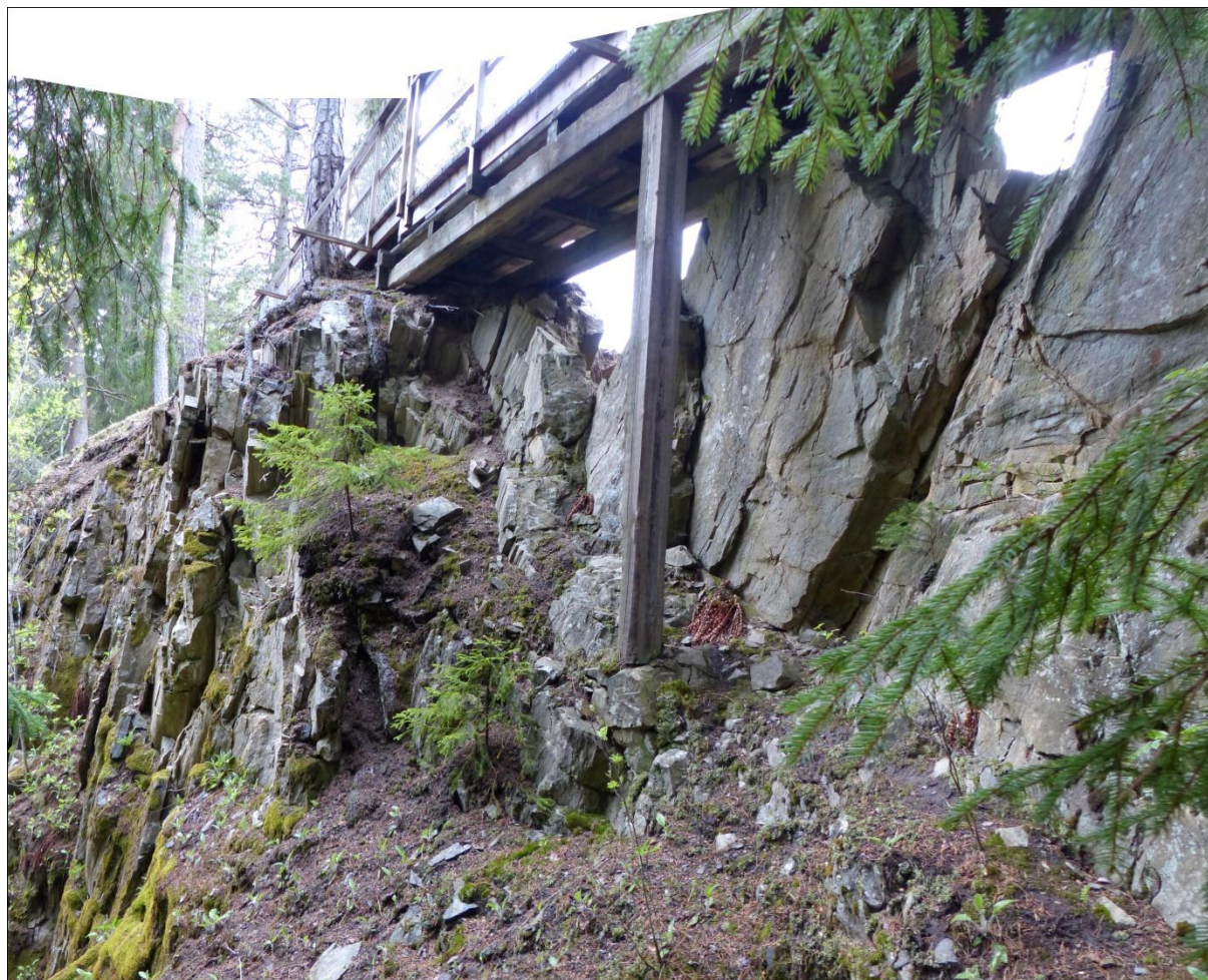
Figur 6. Östra sektionen från sydost. Östra sektionens västra stödpunkt utgörs av en bergklack (se figur 7) med lite lösa jordlager. En grov tall på södra sidan av bron har sina rötter in under västra sektionen samt i sprickor under västra fästpunkten. Östra sektionens södra bärlina har stöd av en vertikal stolpe som vilar på en sprucken och delvis lös bergklack/sten (se figur 9).
