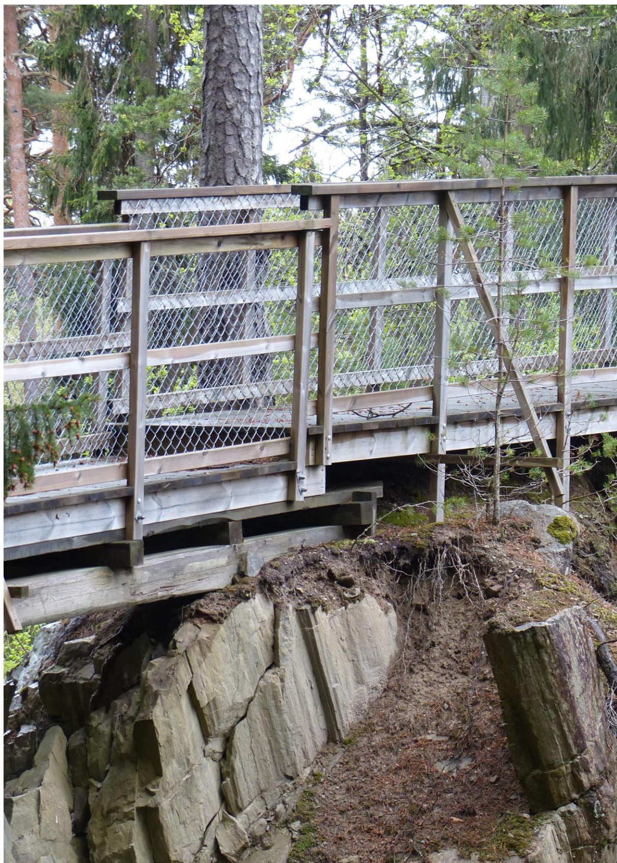
Figur 8. Skarven mellan östra sektionens västra fäste och östra sektionens östra fäste sedd från nordost. Östra sektionens norra bärlina vilar på bergklack med lite lös jord (se även figur 7 som visar samma punkt från undersidan av bron).
