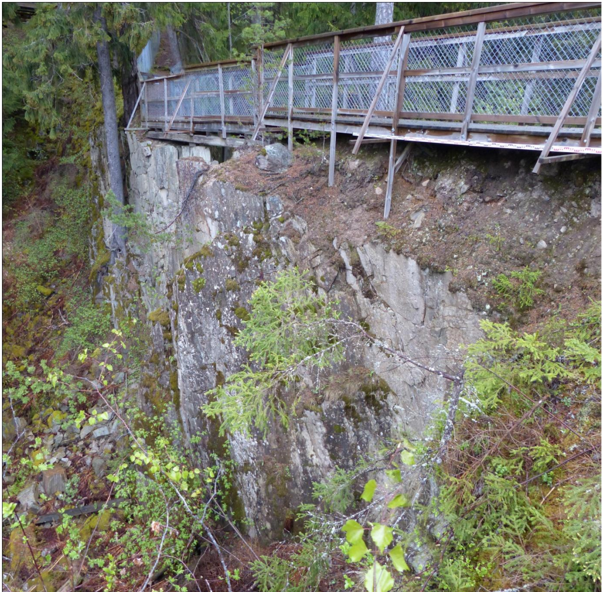
Figur 12. Västra och östra sektionens norra sida sett från nordväst. Västra sektionens regelvirkeskonstruktion hänger utan stöd på den norra sidan där lösa jordlager rasat. Se även figur 13.
