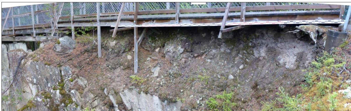
Figur 13. Västra sektionens norra sida sedd från norr. Norra sidans regelvirkeskonstruktion hänger lös i luften utan stöd av de lösa jordlagren. Stödpunkt på norra sidan i väster utgörs av cementplint, vilken dock (se figur 14) även den förlorat sitt stöd då de lösa jordlagren rasat undan. I dagsläget finns inget som hindrar fortsatt erosion av de lösa jordlagren vilket gör att allt stöd för västra sektionen riskerar att eroderas bort.
