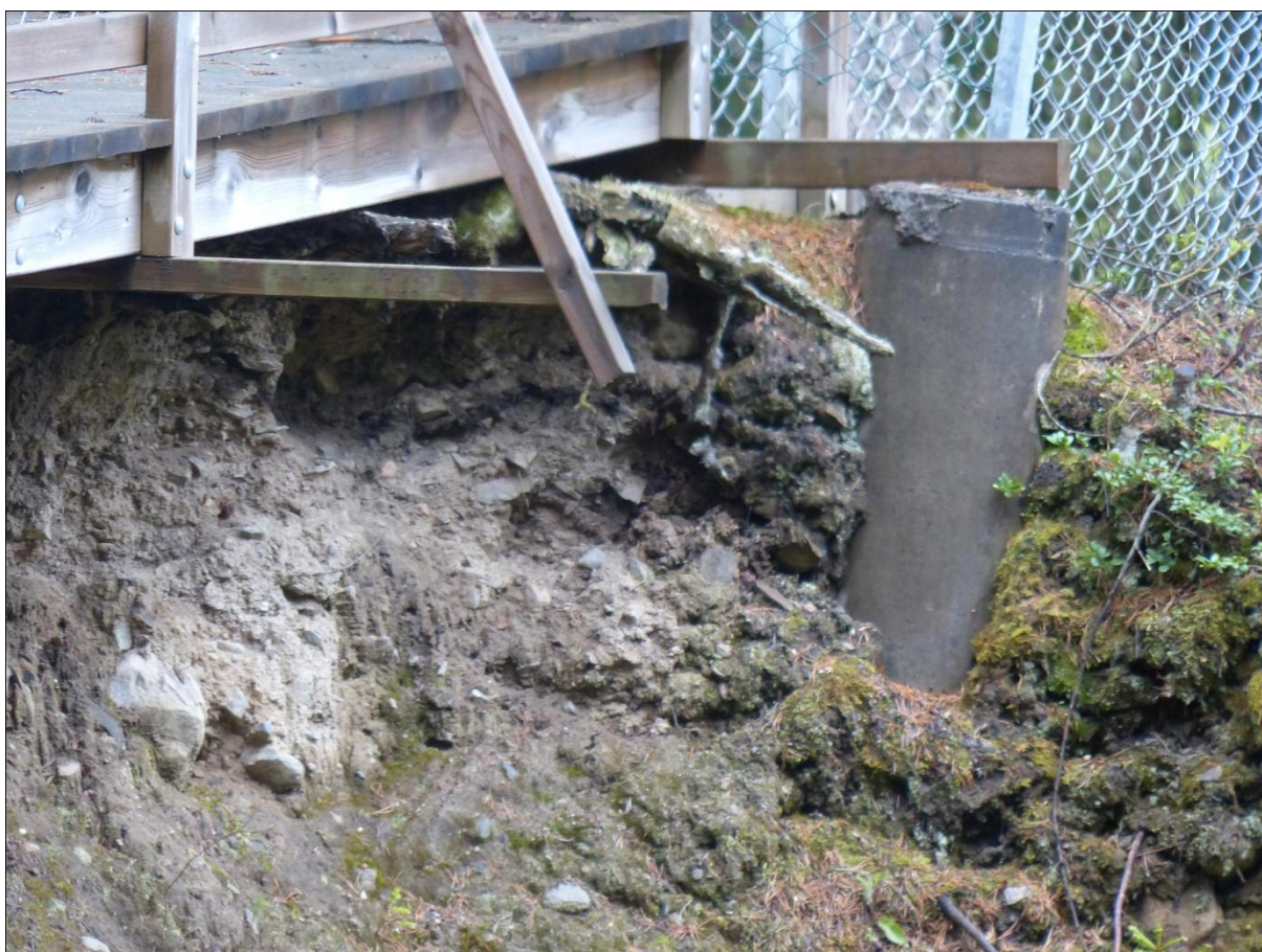
Figur 14. Västra sektionens västra fäste på norra sidan. Sett från Öster. Cementplinten som hjälpligt fixerar västra sektionens regelvirke står lös utan stöd av jordlagren. I plinten är också västra anfartens staketstolpe fixerad.
