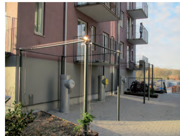
Fastighetsnära sopsortering - Här i Norra Djurgårdsstaden
