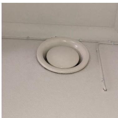
Exempel på frånluftsdon
